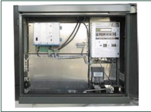
Vista con Control Remoto Supervisorio equipado con un control del interruptor Serie 5800 de EnergyLine.
