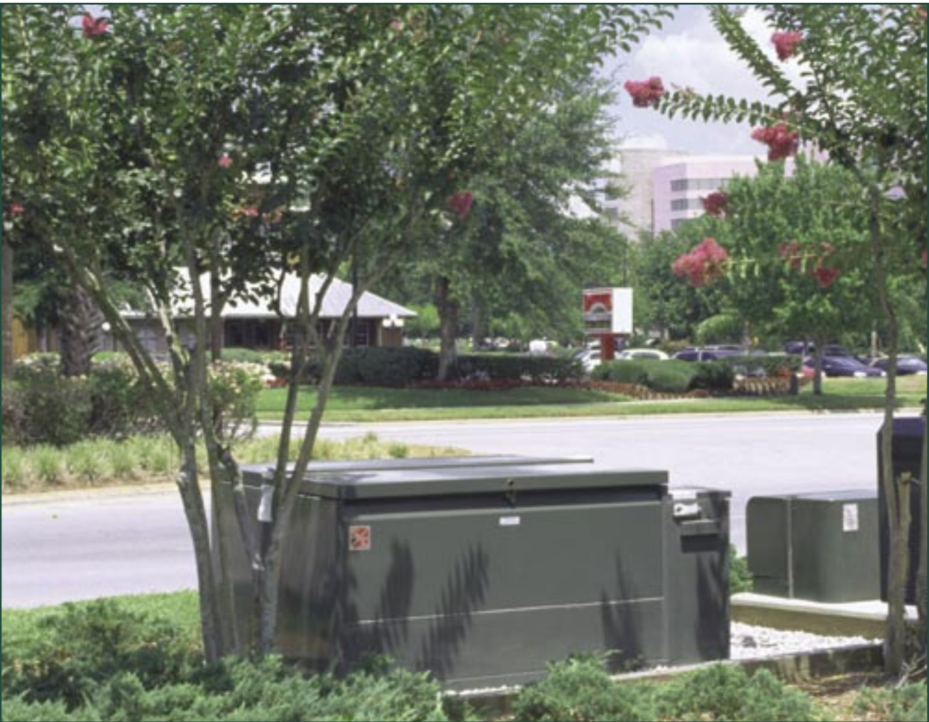
Instalación de un Vista estilo Pedestal con Control Remoto Supervisorio.
