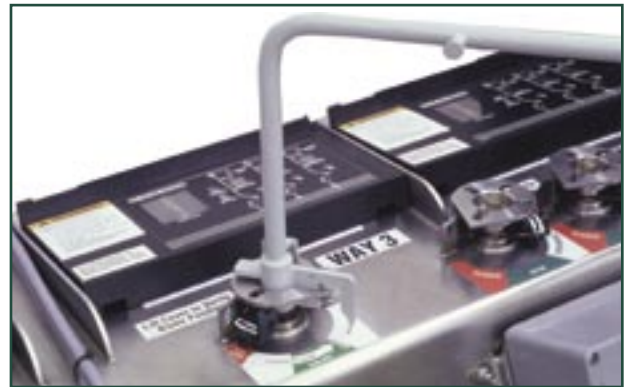
Figura 6. Conectando a tierra el seccionador interruptor de carga (o el interruptor de falla).
