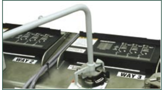
Figura 1. Posición de abierto del seccionador interruptor de carga (o interruptor de falla).
